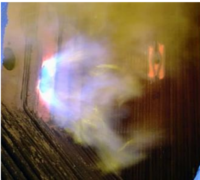
Рис.1 Фотография факела старой горелки в топке котла
