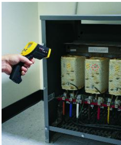
Трансформаторы Поиск неисправности обмотки и контактных соединений.
