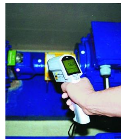
Подшипники двигателя Оценка степени износа подшипников до их полного повреждения.
